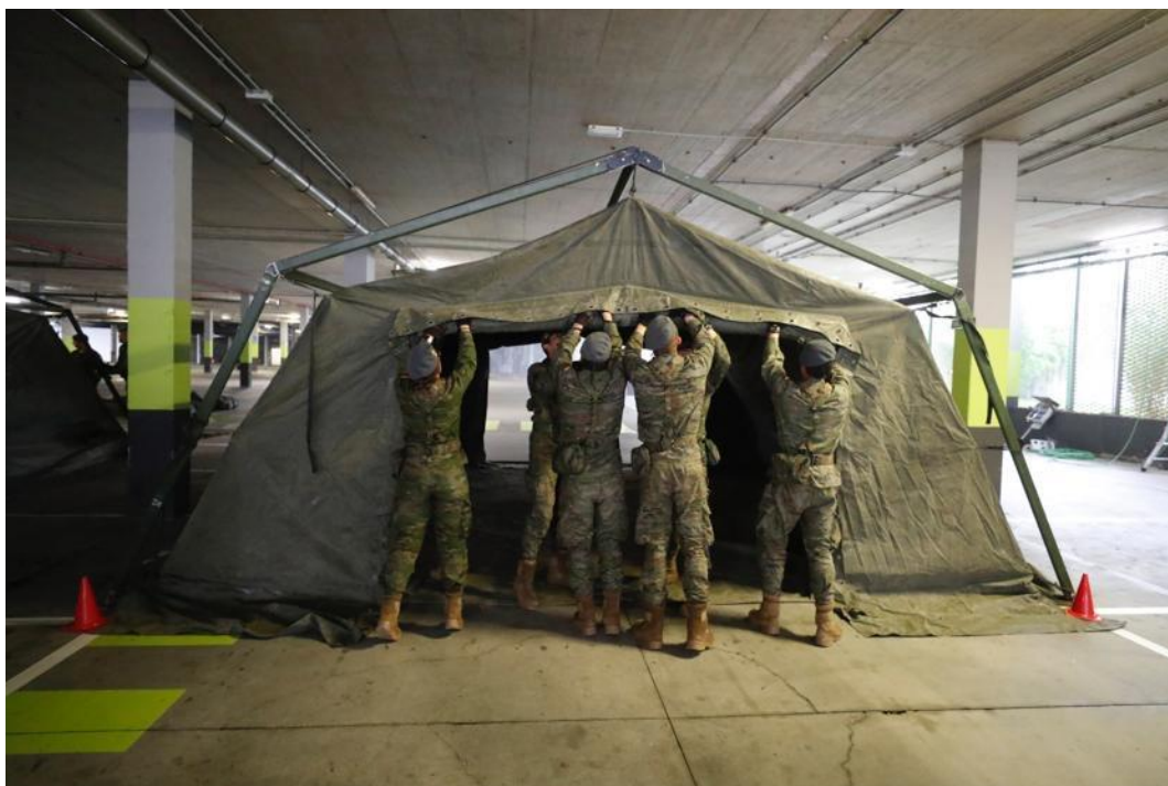
Montaje de un puesto de socorro en el garaje del Hospital Universitario Central de Asturias por militares del RIL «Príncipe» nº3, de la Brilat / ABC
